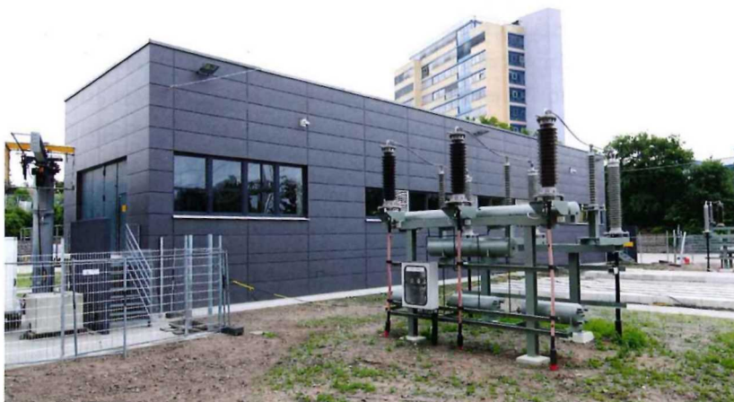
Im neuen 110-kV-Anlagengebäude der Stadtwerke Karlsruhe ist die gasisolierte 110-kV-Schaltanlage untergebracht.
