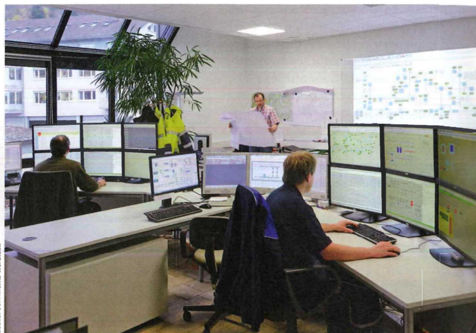
Blick in eine Netzleitstelle
