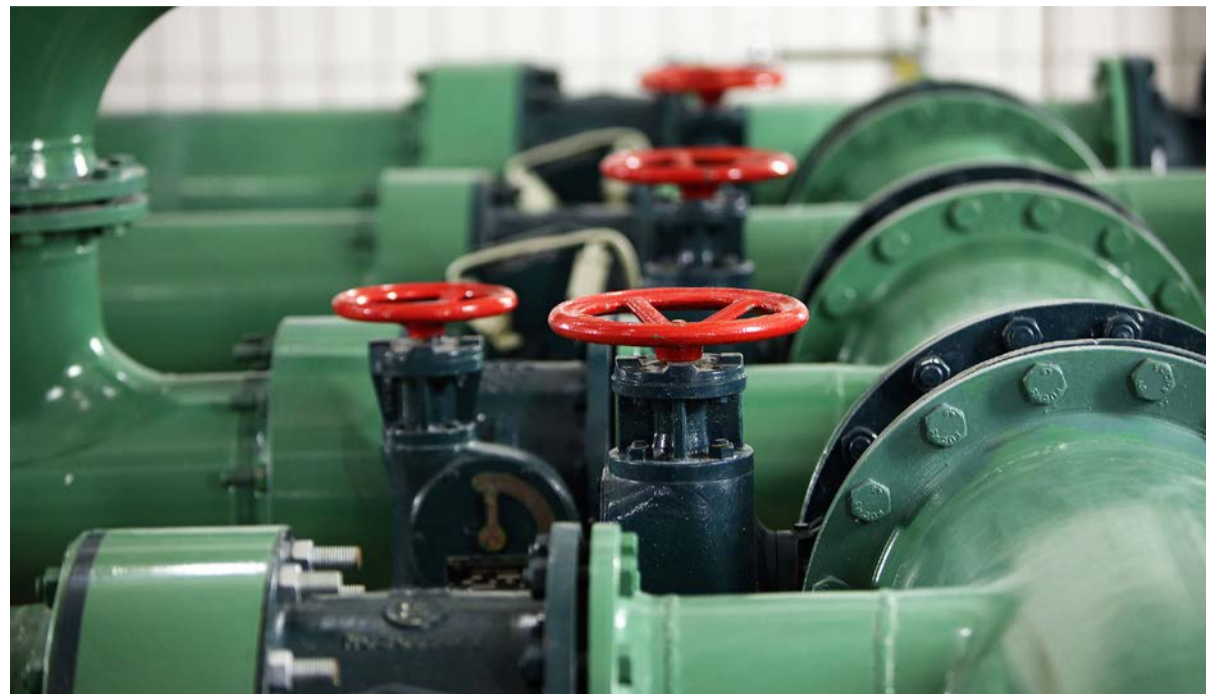
Technische Anlagen des Regionalversorgers TWS.
