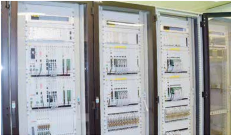
Fernwirkzentrale: Frontendrechner bilden die Basis des Leitsystems.
